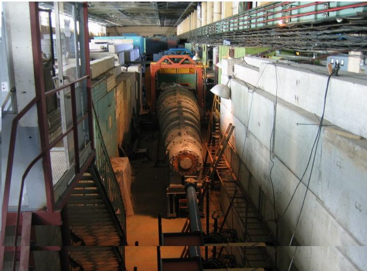
Общий вид установки ОКА
